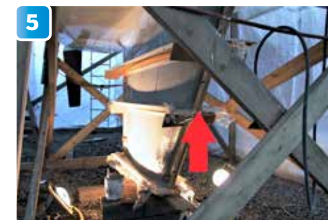
I det här projektet monteras mallarna på bägge kölsidorna samtidigt. Det är A och O att mallarna på både styrbords- och babordssidan hamnar exakt i våg och möter varandras bak- och framkant. Annars kan kölen spacklas snett. Mallarna på de kölsidorna pressas ihop så de går ihop med varandra.
